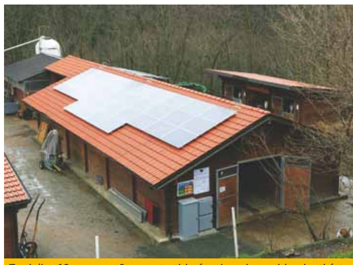
Torriglia, 12 marzo - Sono entrati in funzione i nuovi impianti fotovoltaico e termico a servizio del Centro Equestre Il Mulino di Lupo. Foto M. Carraro.
