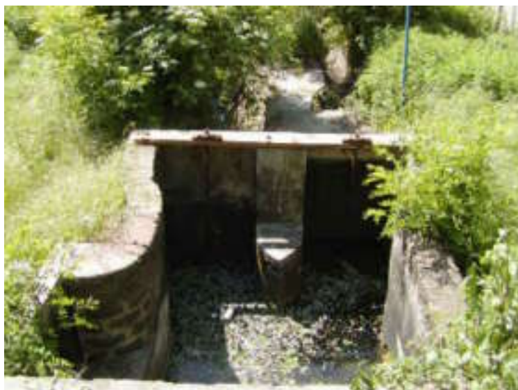
Paratie in corrispondenza del canale secondario per l'alimentazione delle vasche di ravvenamento della falda
