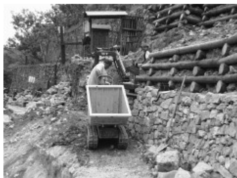
Figura 49 – Recupero di corpo di frana con palificata doppia e rivestimento in pietrame (foto Lazzarotto).
