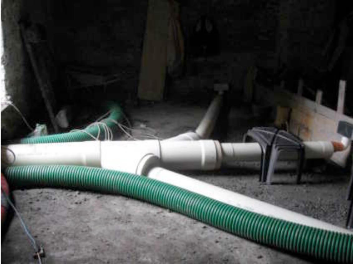
Canalizzazioni interrate per l'aerazione naturale e meccanica (2009)
