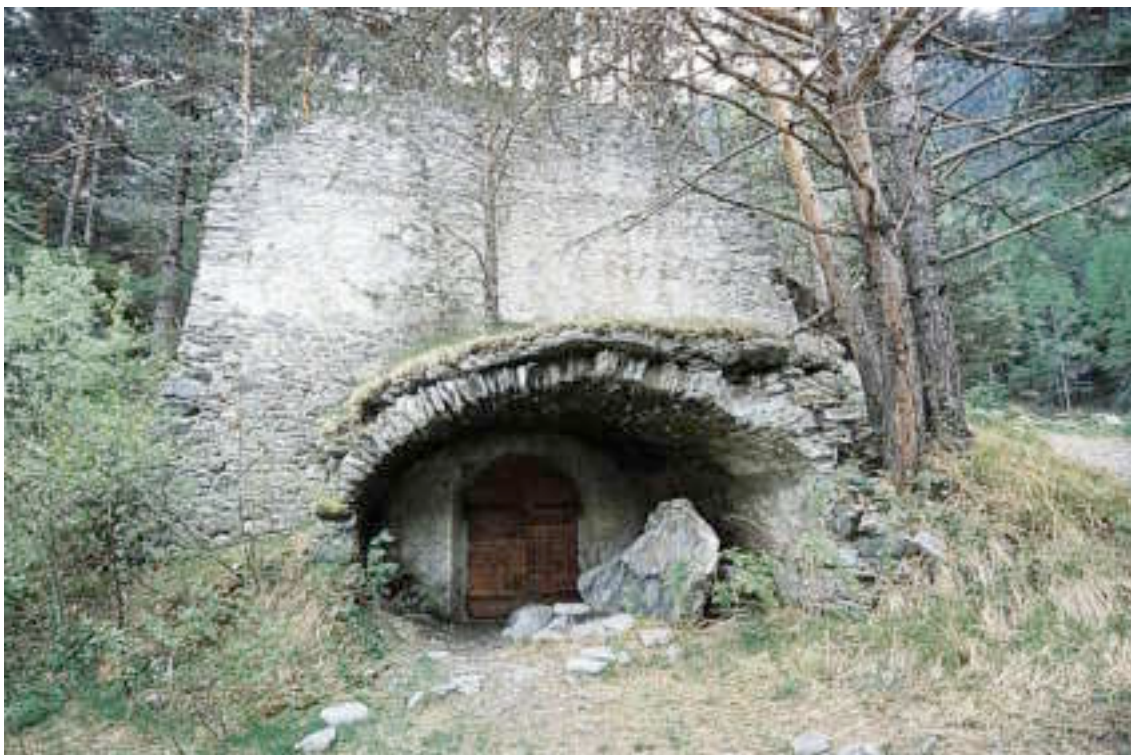
L'ingresso della ghiacciaia prima del crollo totale del voltino (2000)
